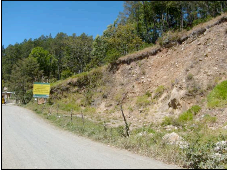
Foto 23.- Coluvión en la carretera de La Ciénaga, a la entrada del Parque Nacional Armando Bermúdez.
