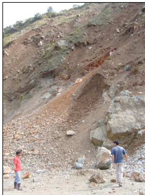
Foto 52.- Obras de reparación de un gran deslizamiento, en la carretera de Jarabacoa a Manabao (2008).
