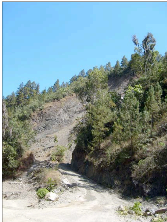
Foto 25.- Movimiento en masa en la carretera de Manabao a La Ciénaga.
