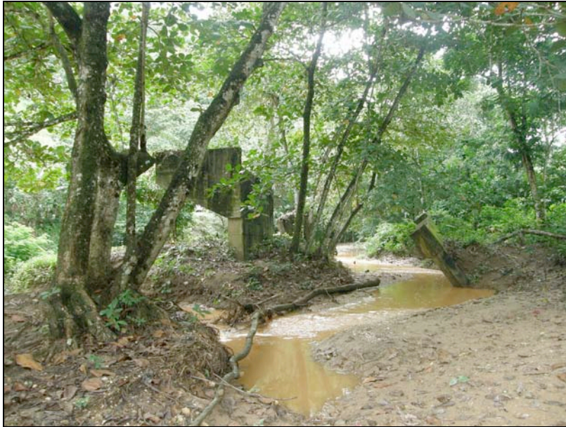
Foto 46.- Puente caído por avenida, en la llanura del Río San Juan cerca de la localidad de El Valle (Península de Samaná).
