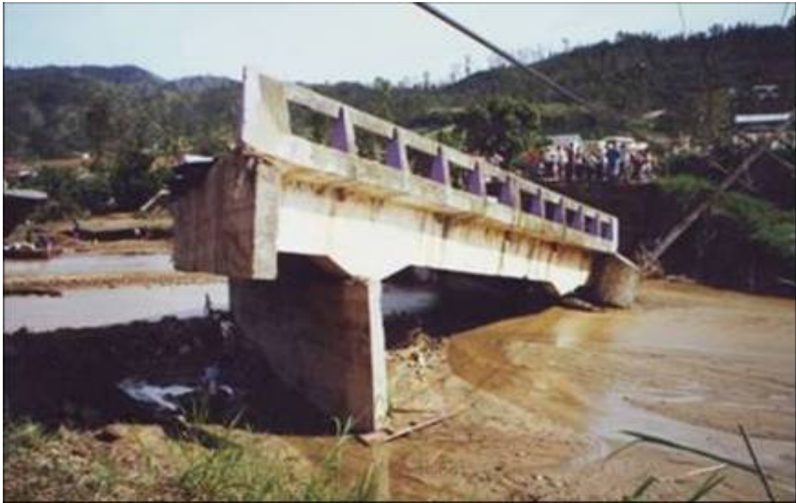
Foto 6.3. Puente sobre el río Tireo derribado con el paso del huracán Georges
